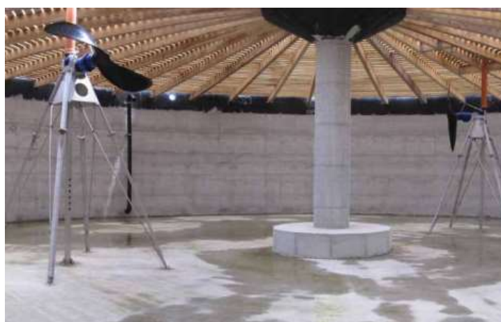
Figura 3.10 – Vista interna de um reator CSTR com destaque para os agitadores mecânicos.
